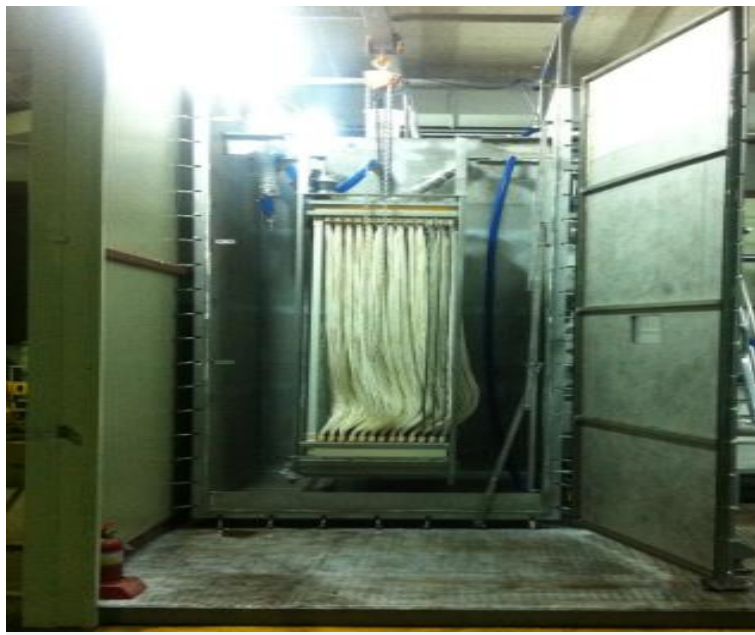
▲제일모직 / 용인 하수처리 Pilot, 150m³/day
