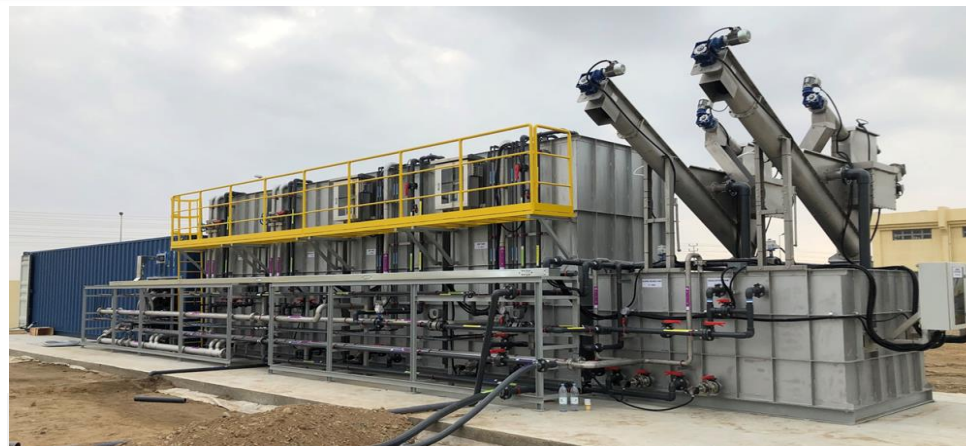
▲ Aerobic Granular Sludge (KAUST, Saudi Arabia)
