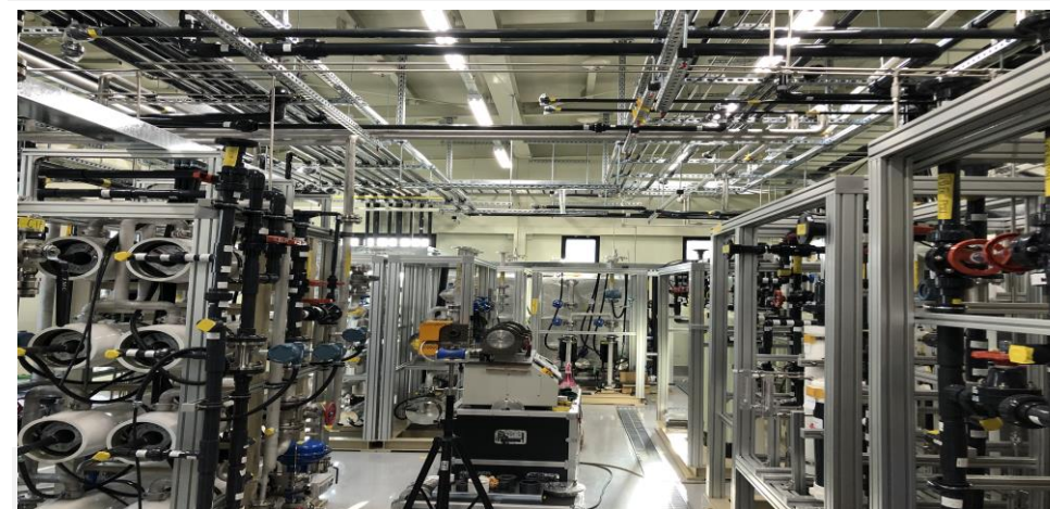
▲ 초순수 Plant (삼성E&A)
