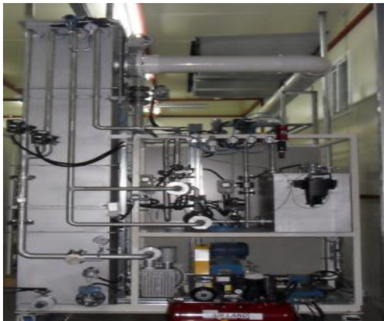
▲제일모직 / 용인 하수처리 Pilot, 60m³/day
